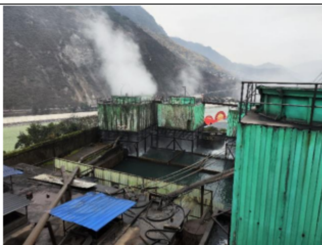
冷却循环水池及冷却塔现状照
